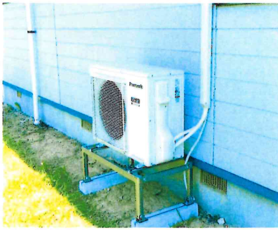
芦ヶ沢集会所に設置されたエアコン室外機
